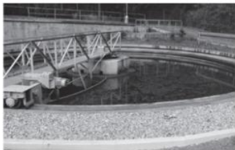
Hình 3.29. Ảnh chụp bể lắng đứng
